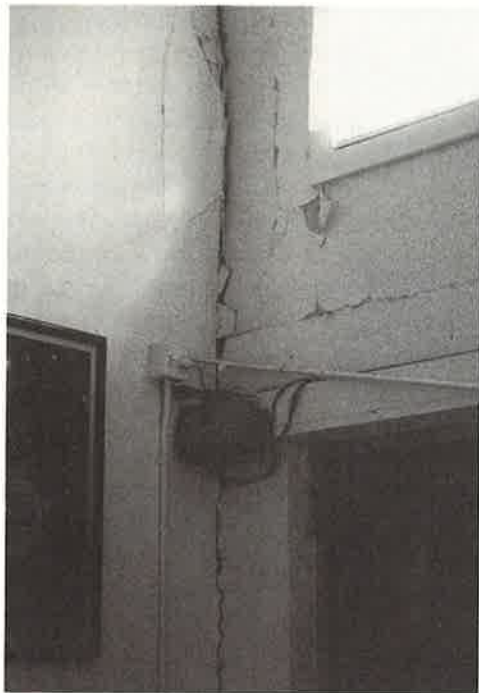
Bild 74, Im Innern sichtbarer über die ganze Raumhöhe führender Abriss einer Gebäudedefrontwand (Pacific Garden Mall, Santa Cruz)
