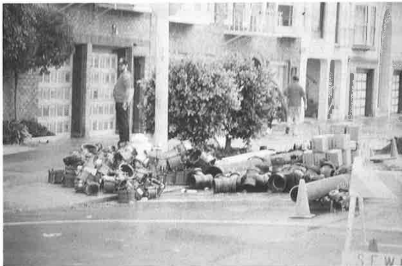
Bild 41, Zur Reparatur der Rohrbrüche notwendiges Leitungsbaumaterial im Marina Quartier vier Tage nach dem Erdbeben
