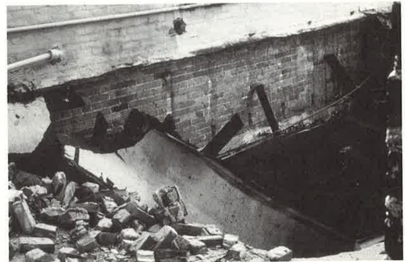
Bild 71, Von den Trümmern eines benachbarten höheren Gebäudes durchschlagenes Flachdach (Pacific Garden Mall, Santa Cruz)
