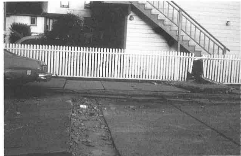
Bild 33, Bodenverschiebungen, welche annähernd einen halben Meter betragen, sind an dem auseinander gerissenen Strassenbelag gut sichtbar
