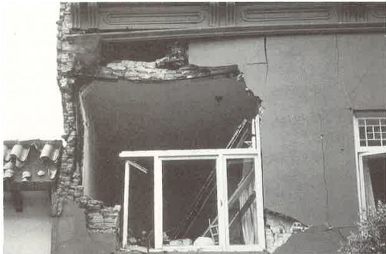
Bild 19, Im Bereich der Gebäudeecke und einer Fensteröffnung schwer beschädigtes Backsteingebäude (Pacific Garden Mall, Santa Cruz)
