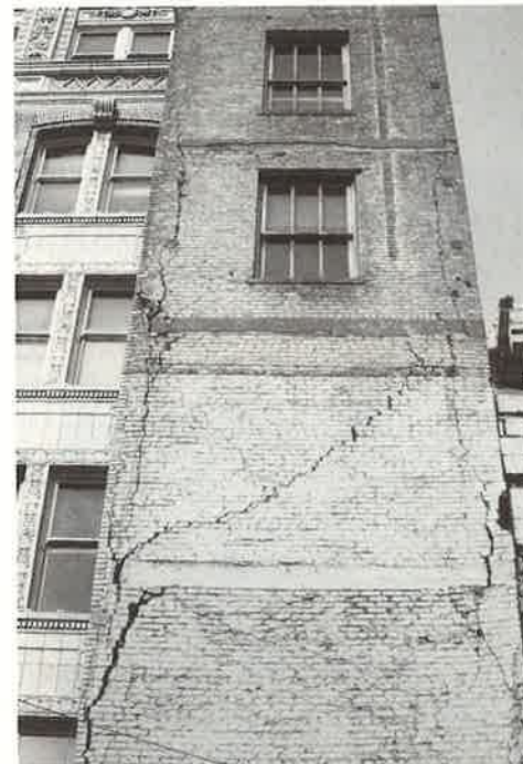
Bild 21, Ausgedehnte Schubrisse in den aussteifenden Backsteinwänden eines 8-stöckigen Stahlskelettbaus in Oakland
