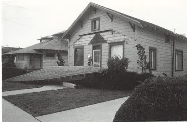
Bild 11, Infolge der seitlichen Gebäudeverschiebung eingestürztes Vordach (Watsonville)
