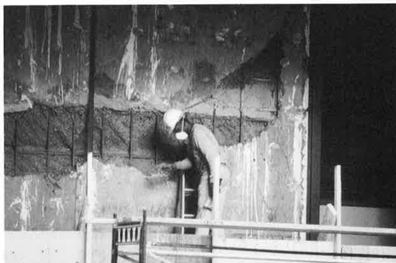
Bild 25, Betonabplatzungen an den Schubwänden im Erdgeschoss eines 15-stöckigen Bürogebäudes im Zentrum von Oakland. Dank des Stahlskelettragwerks dieses Baus kam es zu keinen schwereren Schäden
