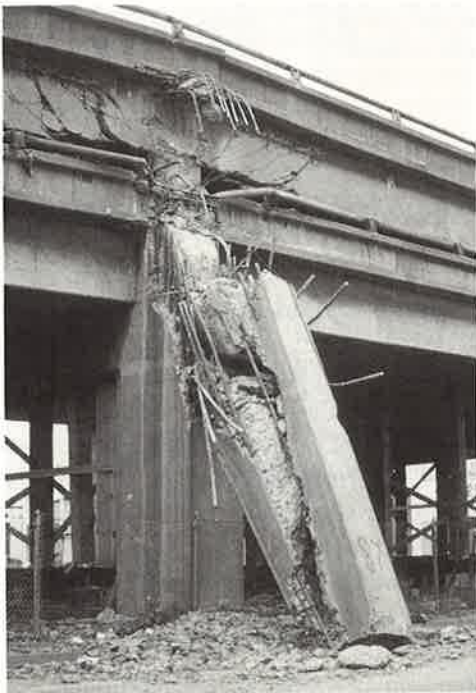
Bild 37, Der Grund für das Versagen der Cypress Brücke ist die ungenügende Bewehrung der Stützen und Rahmenecken
