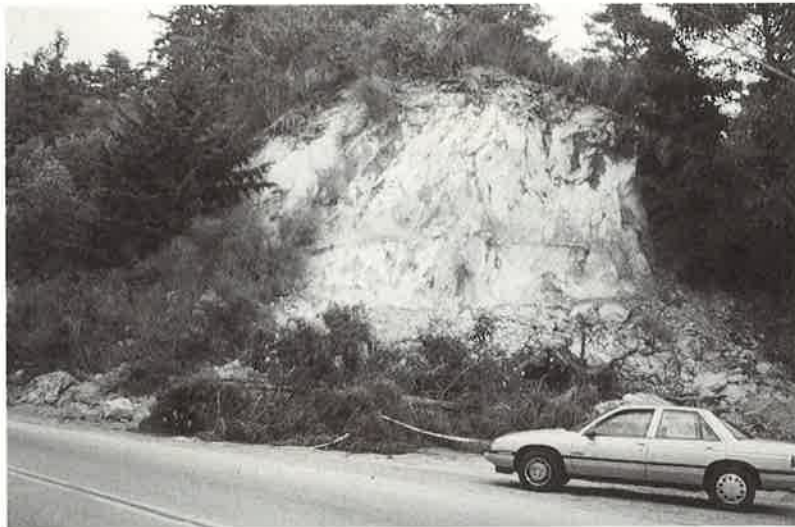
Bild 8, Durch das Erdbeben ausgelöste Rutschung in den Bergen von Santa Cruz
