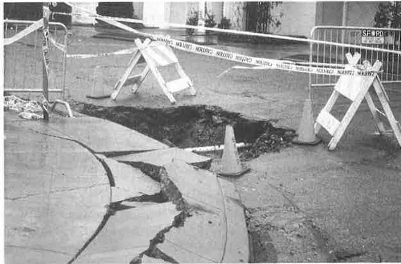
Bild 40, Infolge der grossen Bodenverschiebungen kam es im Marina Quartier von San Francisco zu unzähligen Wasserleitungsbrüchen und einem Ausfall der örtlichen Wasserversorgung
