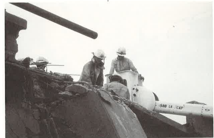
Bild 55, Rettungskräfte bei der Arbeit auf den Trümmern der oberen abgestürzten Fahrbahnen der Cypress Hochstrasse
