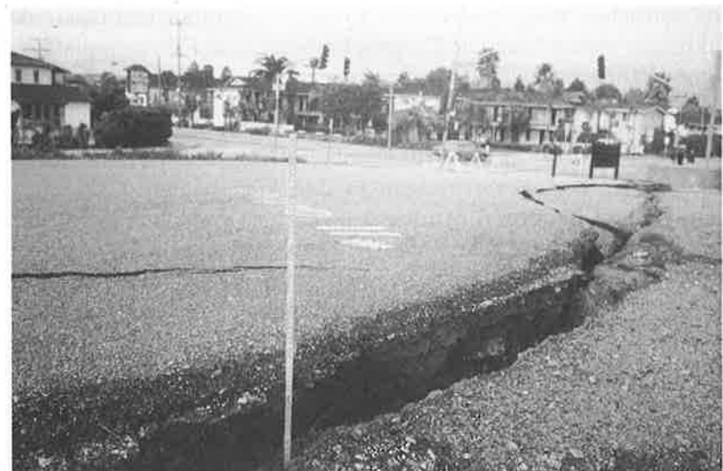
Bild 34, Setzung infolge des wenig stabilen sandigen Untergrunds in der Nähe des San Lorenzo Rivers in Santa Cruz
