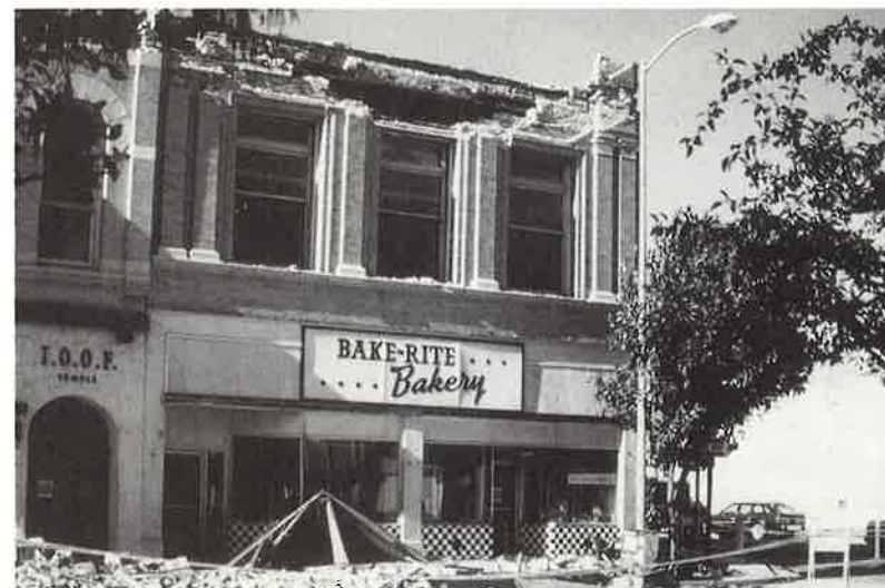
Bild 18, Abgestürzte Mauerwerksbrüstung eines Backsteingebäudes im Zentrum von Watsonville
