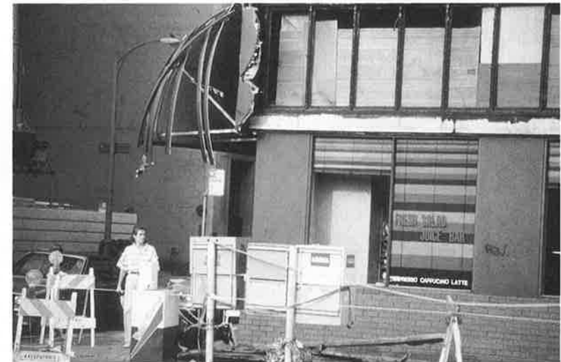
Bild 31, Wegen ungenügenden Befestigungen abgestürztes Vordach in Oakland
