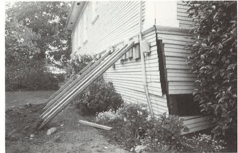
Bild 9, Beschädigte Stützenfundation eines Wohnhauses und Sicherungsmassnahme (Myrtle Street, Santa Cruz)
