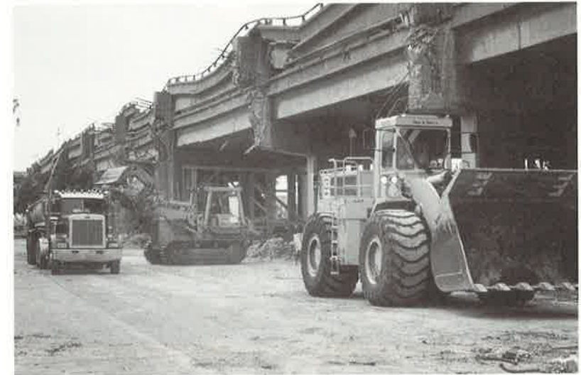
Bild 54, Der Betrieb auf dem Schadenplatz an der eingestürzten Cypress Hochstrasse verlief ausserordentlich ruhig. Dieses zweieinhalb Tage nach dem Beben gemachte Bild zeigt erste Aufräumarbeiten, obschon gleichzeitig die Rettungen noch in vollem Gang waren
