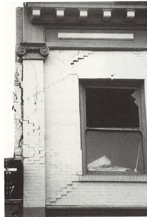
Bild 72, Schwer beschädigtes Mauertragwerk an der Pacific Garden Mall in Santa Cruz. Man erkennt die für Erdbebenbelastungen typischen von den Ecken der Fenster ausgehenden Schubrisse und links den Abriss der Seitenwand (Querwand)
