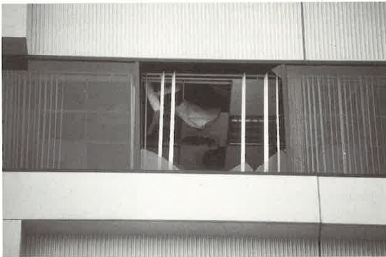
Bild 6, Trans Pacific Center in Oakland mit Schäden an den nicht zum Tragwerk gehörenden Einbauten wie Verglasungen und Deckenverkleidungen
