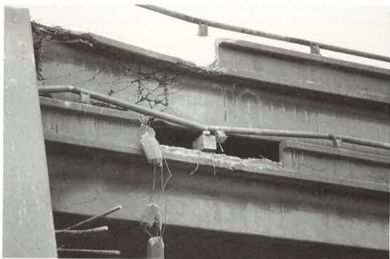
Bild 64, Rettungen in geschichteten Stahlbetontrümmern sind ausserordentlich schwierig. Bei der eingestürzten Cypress Brücke in Oakland mussten die Retter von der Seite in die kleinen Hohlräume zwischen den aufeinander liegenden Fahrbahnplatten kriechen, um die verschütteten Fahrzeuge zu lokalisieren. Um später von oben zu den Verschütteten vorzudringen, wurde die Distanz vom Fahrbahnrand mit Farbspray auf den Brückenrand aufgespritzt. An der abgebildeten Stelle befindet sich in 20' (ca. 6 m) Entfernung ein verschüttetes Fahrzeug.
