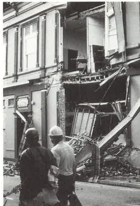
Bild 17, Wegen der ungenügenden Verbindungen mit der Holzbalkendecke eingestürzte Wand (Pacific Garden Mall, Santa Cruz)
