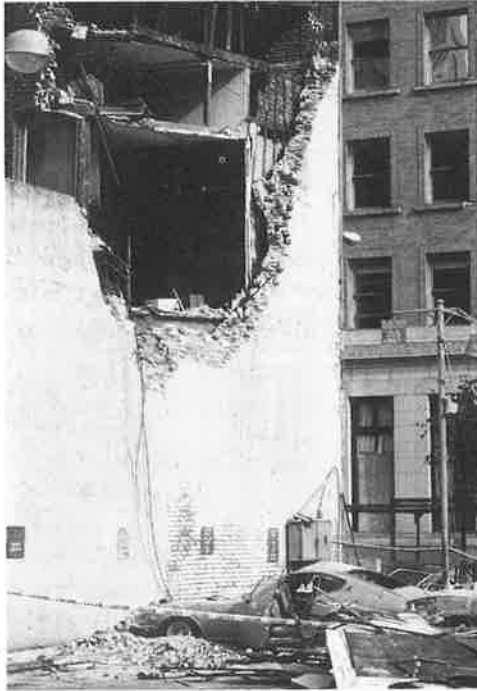
Bild 22, Eingestürzte Mauerwerkswand eines älteren Backsteingebäudes im Zentrum von Oakland
