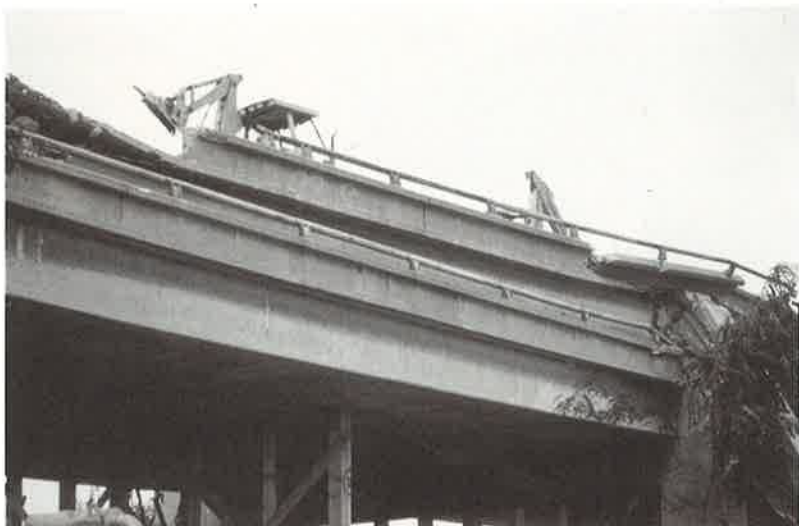
Bild 60, Um in die Trümmer einzudringen, setzten die Rettungskräfte Baumaschinen, wie Bagger mit angebauten Hydraulikhämmern ein. Gut sichtbar sind die Stützkonstruktionen zur Sicherung der beschädigten Hochstrasse
