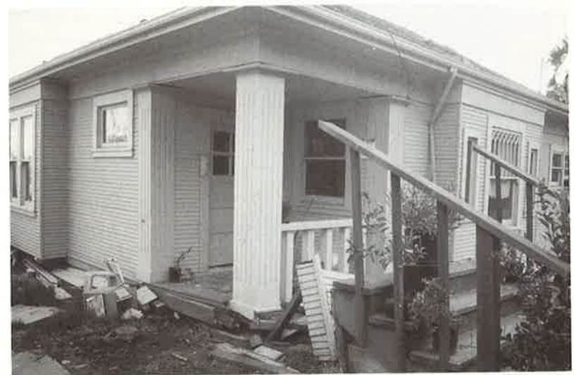
Bild 10; Beim vollständigen Versagen der Stützen betrug die seitlichen Gebäudeverschiebungen oftmals weit über einen Meter. Man beachte die Eingangstreppe vorne rechts (Myrtle Street, Santa Cruz)
