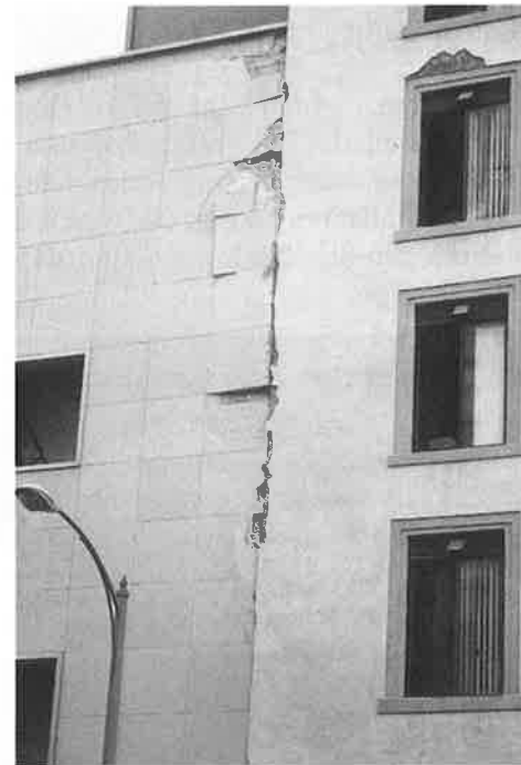
Bild 30, Fassadenschaden im Bereich der Gebäudedilatation, hervorgerufen durch das Aneinanderschlagen von verschieden hohen und dadurch unterschiedlich schwingenden Bauten
