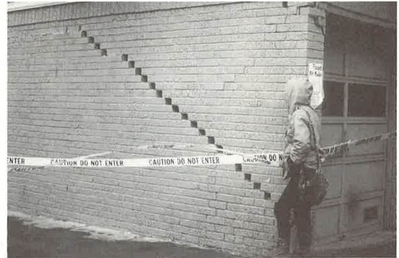
Bild 15, Schubriss in der gemauerten Seitenwand eines durch Garageneinfahrten "geschwächten" Erdgeschosses ("soft storey") im Marina Quartier
