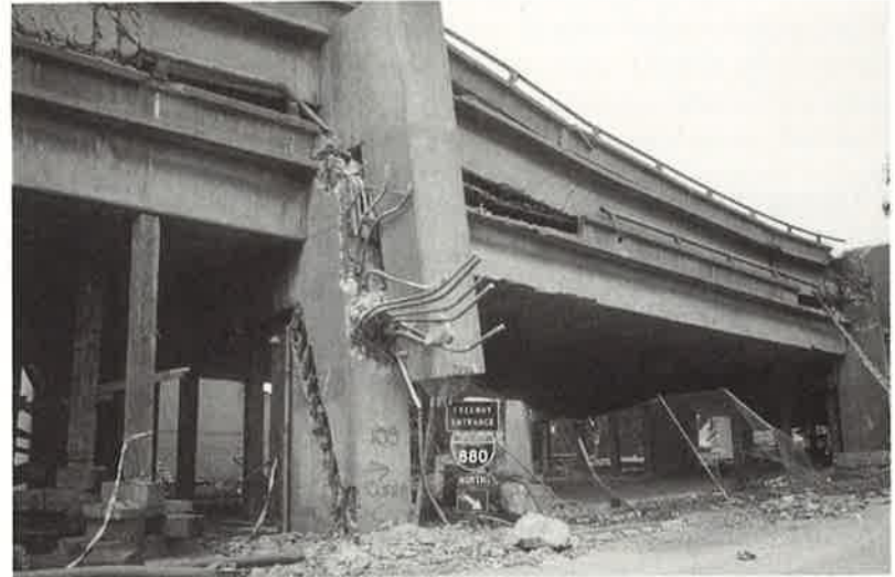
Bild 38, Der Versagensmechanismus der Stahlbetonrahmen ist an den Stellen, an denen die Stützen selbst nicht versagten, gut zu erkennen
