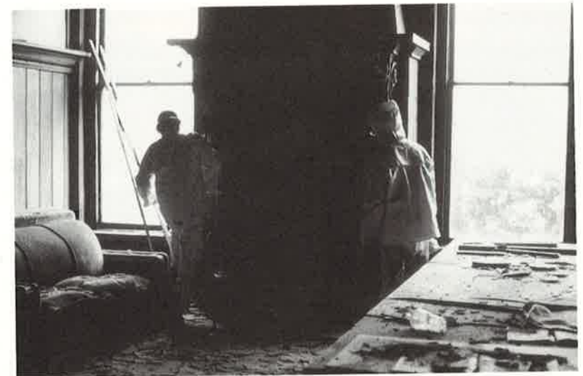
Bild 73, Schadenbeurteilung durch die Expertengruppe im Innern des oben abgebildeten Gebäudes
