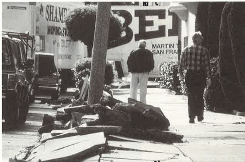
Bild 14, Durch das Erdbeben aufgeschobener Strassenbelag im Marina Quartier
