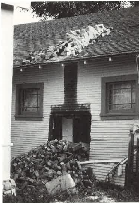
Bild 12, Einstürze von gemauerten Kaminen sind überaus häufige Erdbebenschäden
