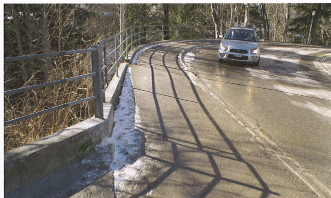
Geländer werden in speziellen Fällen auf Banketten angeordnet. Damit wird für das Rückhalten von Motorfahrzeugen eine beschränkte Wirkung erreicht, wie dieses Beispiel in Adelboden BE zeigt.
