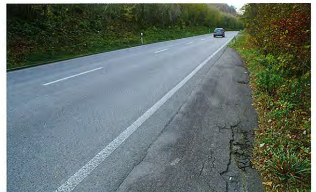
7: Typischer Schaden am Belagsrand.
