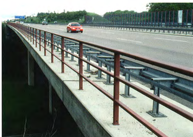
6: Distanzleitschranke EDLS A und Geländer, Deutschland.
