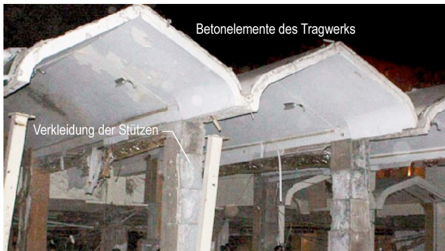
17: Hoteleingang mit Trümmern. Bei den Stützen des Vordachs erkennt man abgerissene Fassadenplatten, das Tragwerk ist jedoch noch weitgehend intakt.
