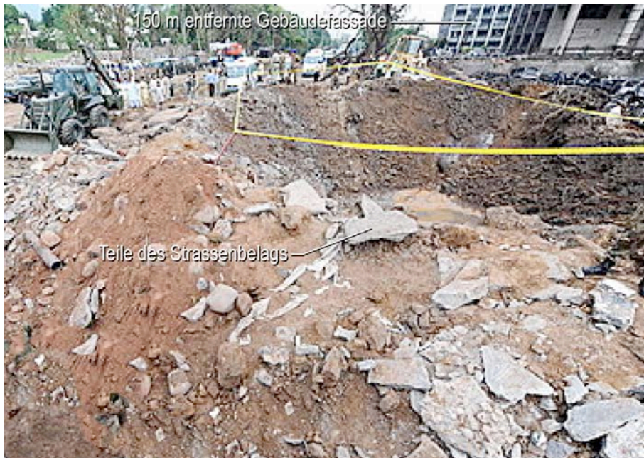
12: Kraterrand mit Bruchstücken des Belags und ausgeworfenem Bodenmaterial. Im Hintergrund erkennt man die 150 m entfernte Fassade des Nachbargebäudes
