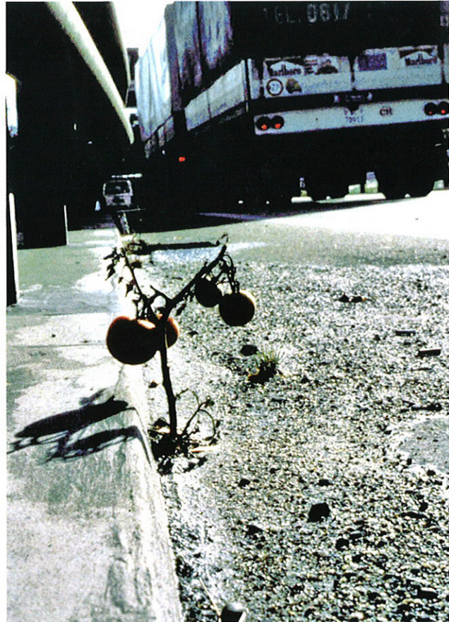
2: Verstopfter Ablauf auf einer Brückenentwässerung.
