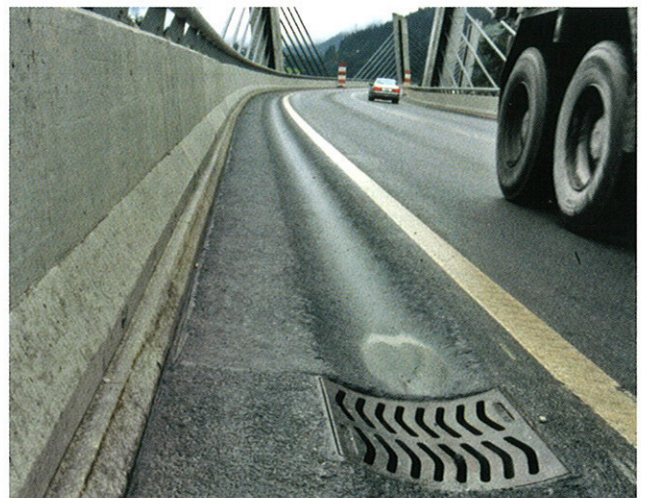
6: Rinne zwischen Fahrbahn und Brückenrand im Hinblick auf abfliessendes Schmelzwasser von geräumtem Schnee.
