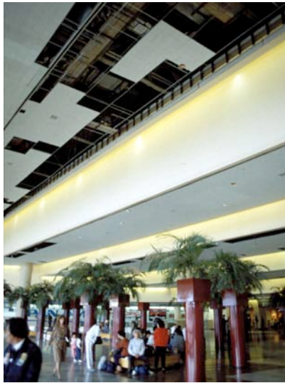
Bild 2 Erdbebenschäden an der Deckenverkleidung in der Eingangshalle eines internationalen Flughafens
