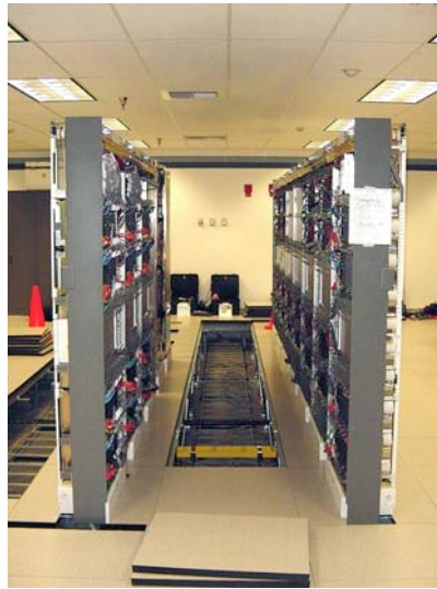
Bild 3 Doppelboden im "Wire-Center" eines grossen Rechenzentrums
