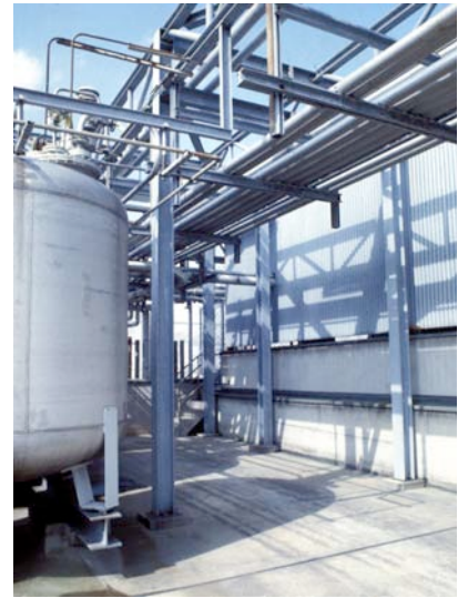
Bild 4 Tankanlagen und Rohrleitungsinstallationen eines Chemiebetriebs auf dem Dach des Gebäudes
