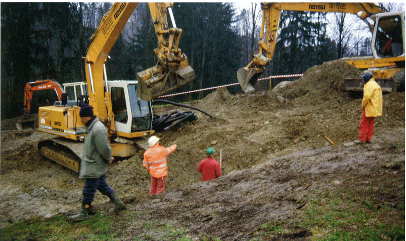
6: Domaine de diffusion directement sous l'endroit de la fuite dans un versant pentu avec alternance de couches perméables et imperméables.
