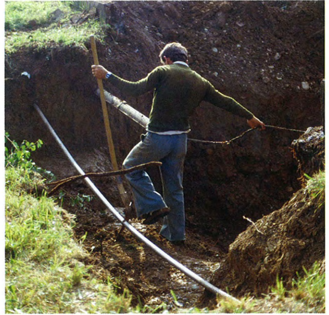
8: Ausbreitung von Heizöl längs Hausanschlussleitungen.
