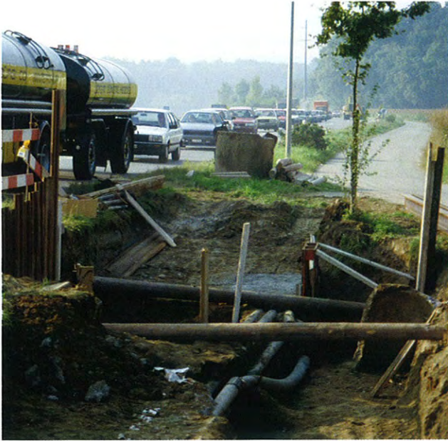
7: Ausgangspunkt einer grossflächigen Ausbreitung von Heizöl durch die Fundationsschicht der Strasse und durchlässige Umhüllungen von Leitungen.
