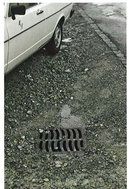
Abb. 5 Ungünstiger Anschluss der tonigen Deckschicht an Ablauf.
