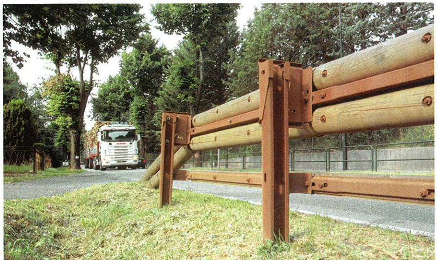
Hybride Stahl/Holz mit Planken mit Stahlprofilen und Rundholz als Längselement und Pfosten auf Stahl, Aufnahme in Italien.
