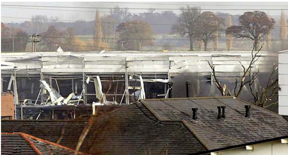
Auf der gesamten Länge zerstörte Metallfassade der Halle (5)
