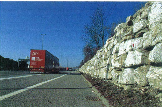
13: Ungünstige Böschungssicherung mit unebener Oberfläche.
