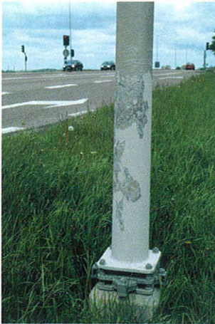
9: Umfahrbare Beleuchtungskandelaber mit Gleitfussplatte.
