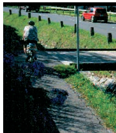
6: Pont sans garde-corps sur un ruisseau.
