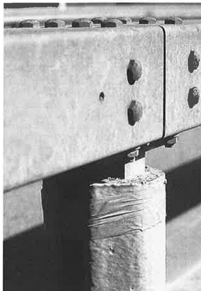
3: Mit Schaumstoffpolster ummantelter Leitschrankenpfosten.
