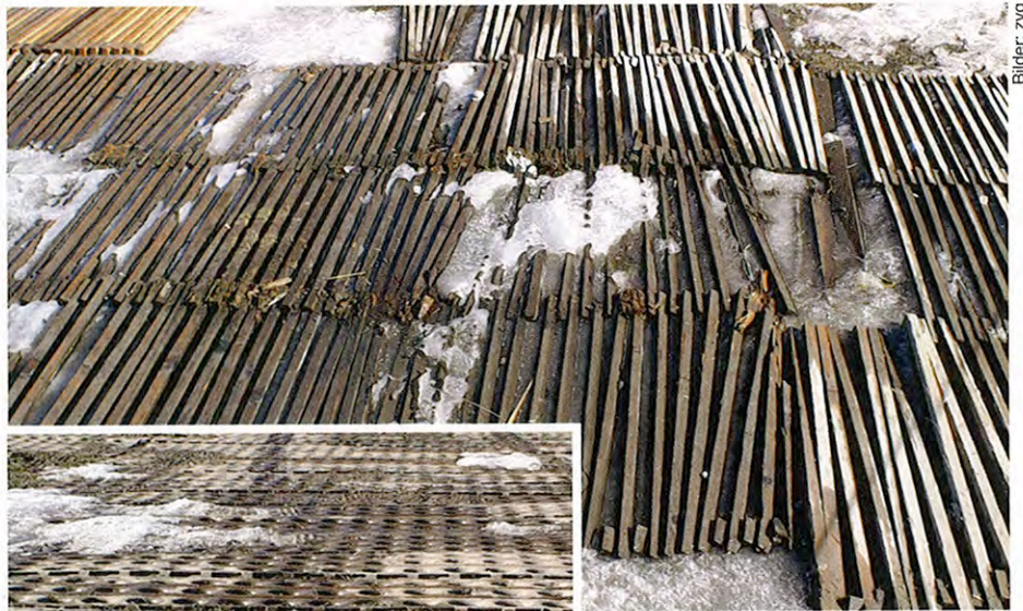
Einfahrt zu einem Abstellplatz mit Schäden an Holzlatten.
